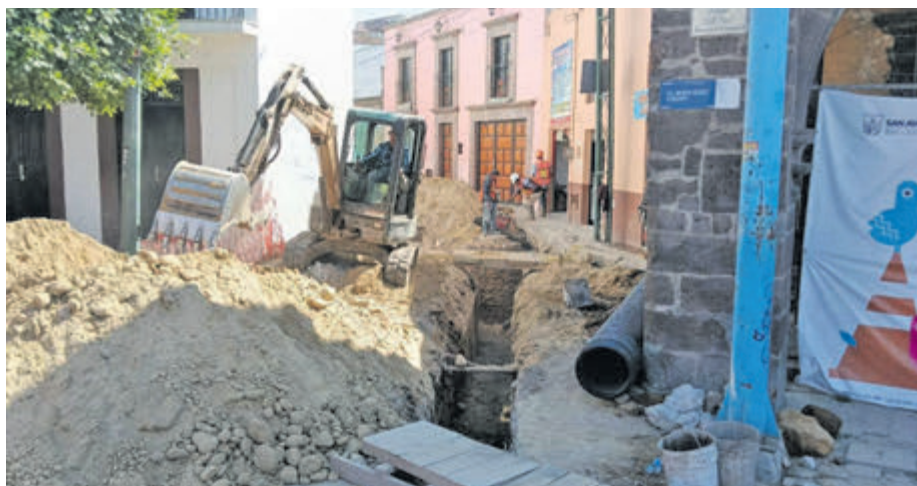
Se han detectado obstrucciones en la infraestructura hidráulica. JENA GUZMÁN
