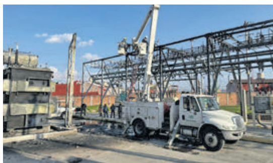
La CFE fortalece el suministro eléctrico en el estado. ESPECIAL
