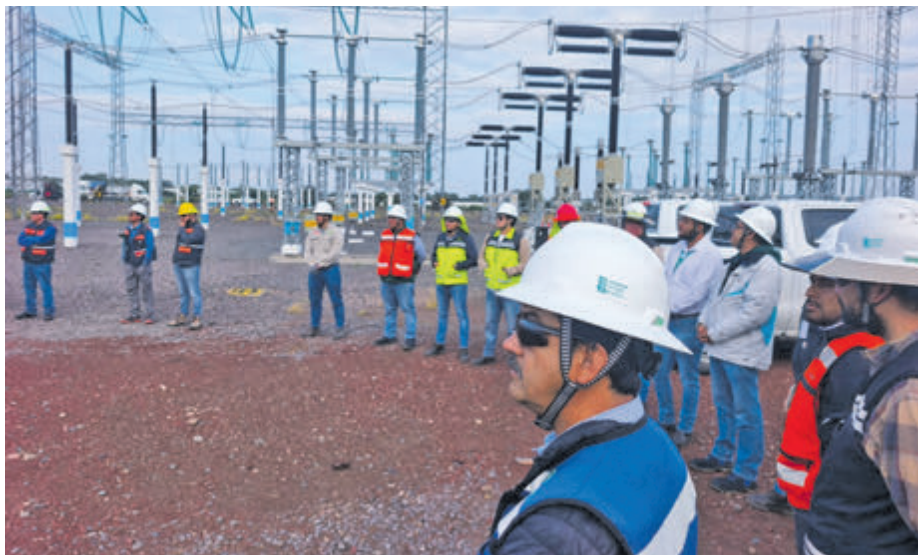
Se trata de una Nueva Línea de 400 mil volts del Centro de Carga RLX para fortalecer obras instruidas a la Compañía Ammper. CORTESÍA
