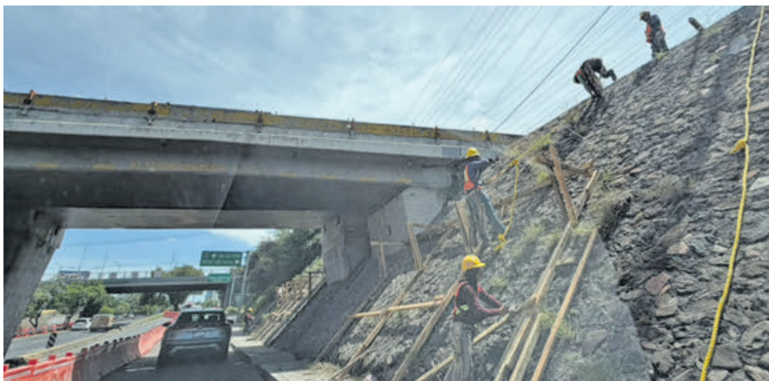
Las principales afectaciones se concentran en el perímetro de la obra. ESTRELLA ÁLVAREZ
